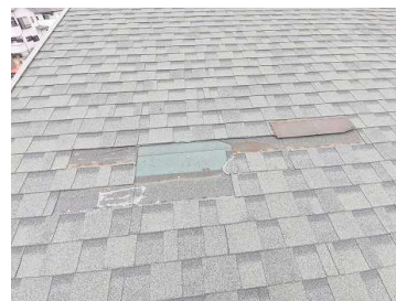
台風による屋根材の欠落
