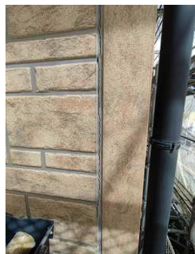
コーキングの劣化
