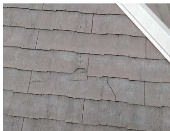
屋根材の割れ・ヒビ
