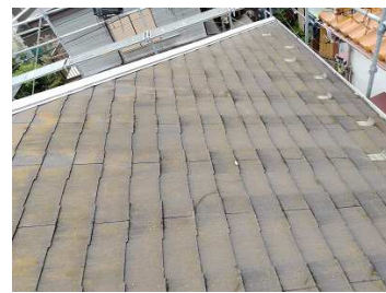
屋根材の色褪せ
